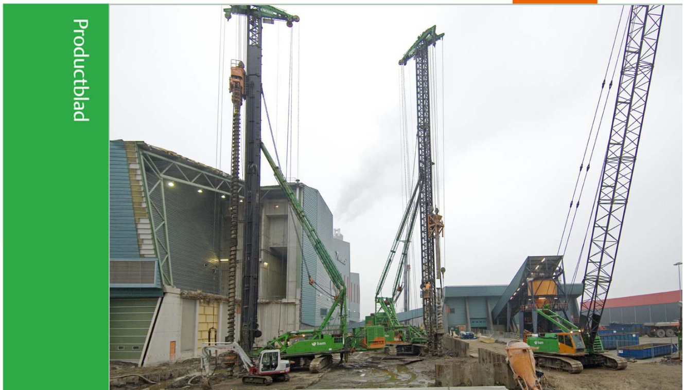
Derde verbrandingslijn afvalenergiecentrale Twence, Hengelo
