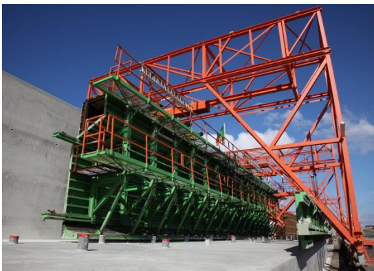
De elementen van de L-wandconstructie zijn met een rijdende portaalkist in één keer gestort.
